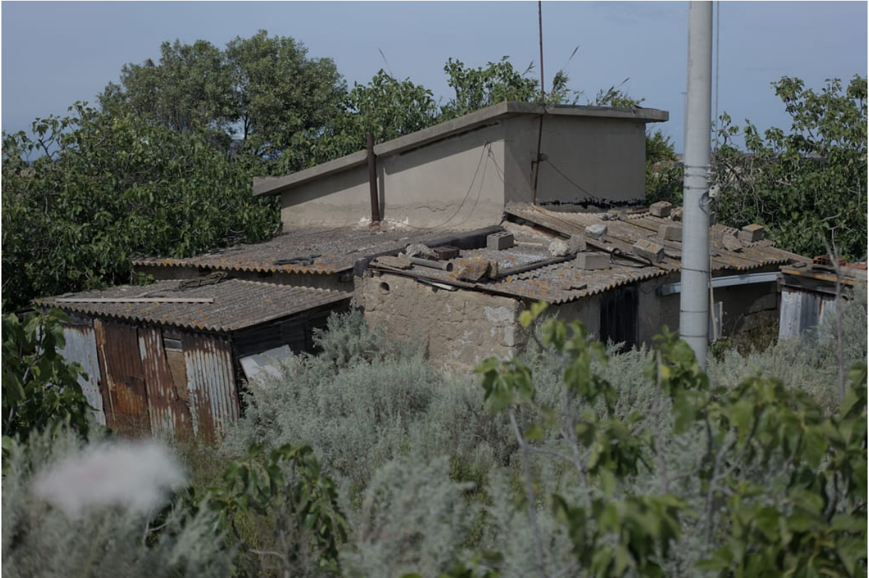
Borgata di Ponte romano. Una delle baracche fatiscenti con Eternit (foto Pitzoi Arcadu)
