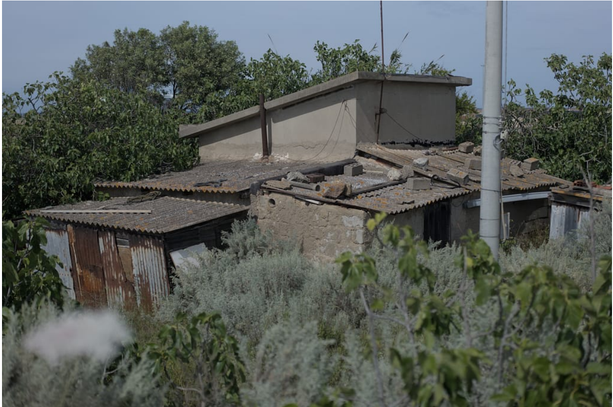
Borgata di Ponte romano. Una delle baracche fatiscenti con Eternit (foto Pitzoi Arcadu)
